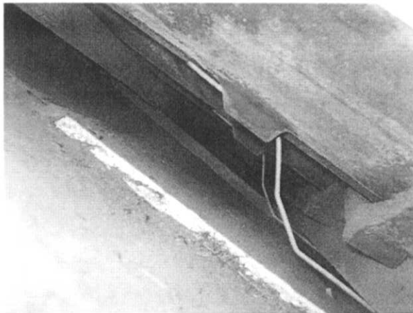
Tidligere repareret skade på undertag (Lapning)
