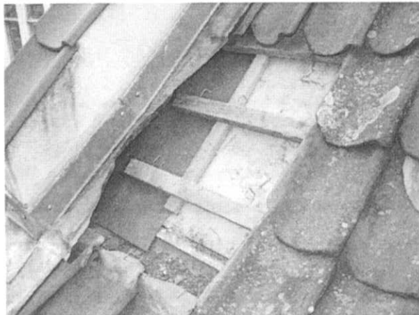
Oplukning af tagflade ved inddækning mod brandkam. Der ses fugtskjolder på undertaget.
