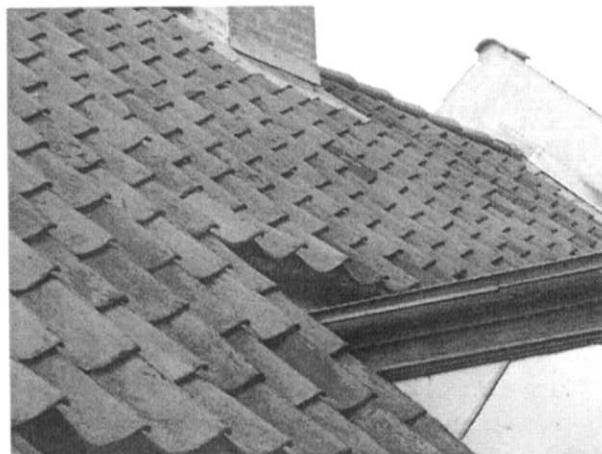
Tegl som er kæntret over nye kvisttage pga. for stor udkravning over nederste lægte.
