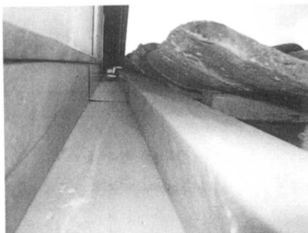
Utætheder og store åbninger til undertaget ved afløbsrende ned langs kvistflunke.
