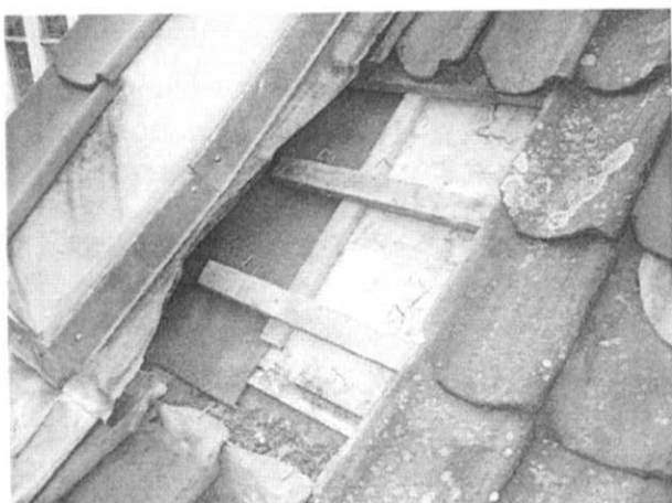
Oplukning på tagflade ved brandkam på gadesiden.
