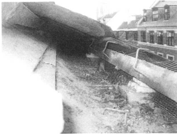
Inddækning i zink med udførte reparationer af lodning.
