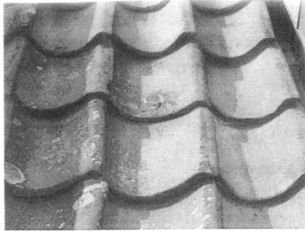
Tegl som fremstår nedbrudte i overfladen med revner, afskalninger.
